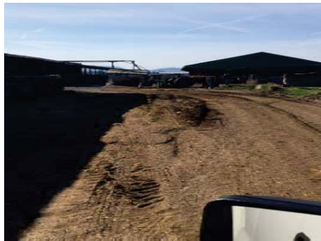
Broken slab (before)
